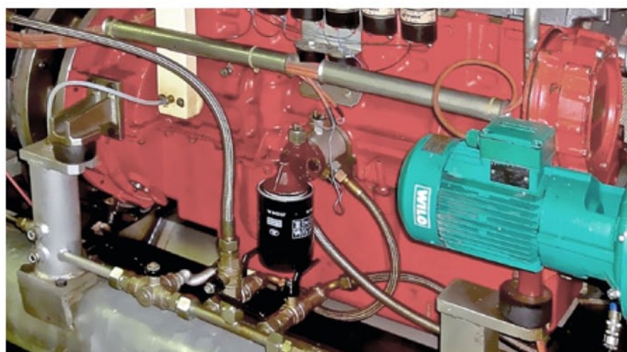
Kraft-Wärme-Kopplung (KWK): Blockheizkraftwerk (BHKW)-Module mit 50 kW el /100 kW th
